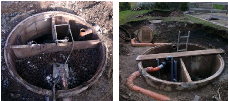
Bild 1 und 2: Umbau einer Tropfkörperanlage (42 EW) zu einer KLARO SBR mit Drucklufttechnik
